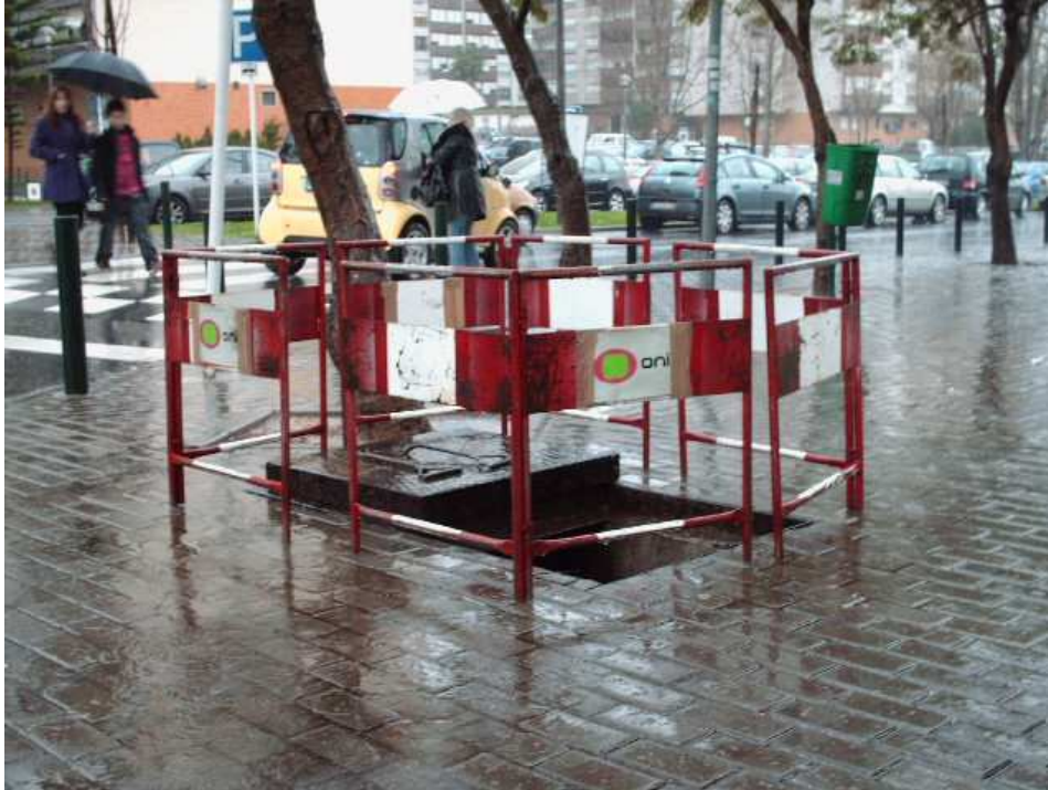
Imagem 1. Exemplo de Sinalização da entrada na Câmara de Visita
